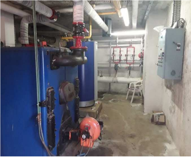
Vue générale de la chaufferie
