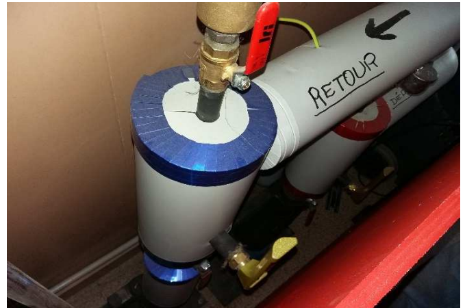
Arrivée du réseau dans la maternelle
