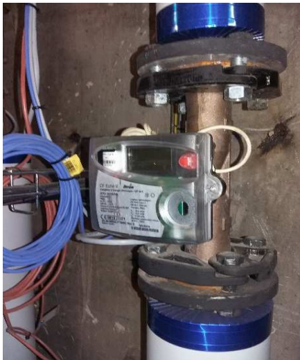
Compteur du circuit St Exupéry
